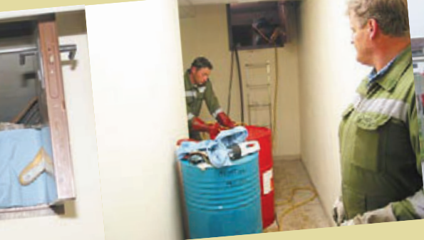
15. September 2005: Ölaustritt im Heizöltankraum der Fa. EVG
